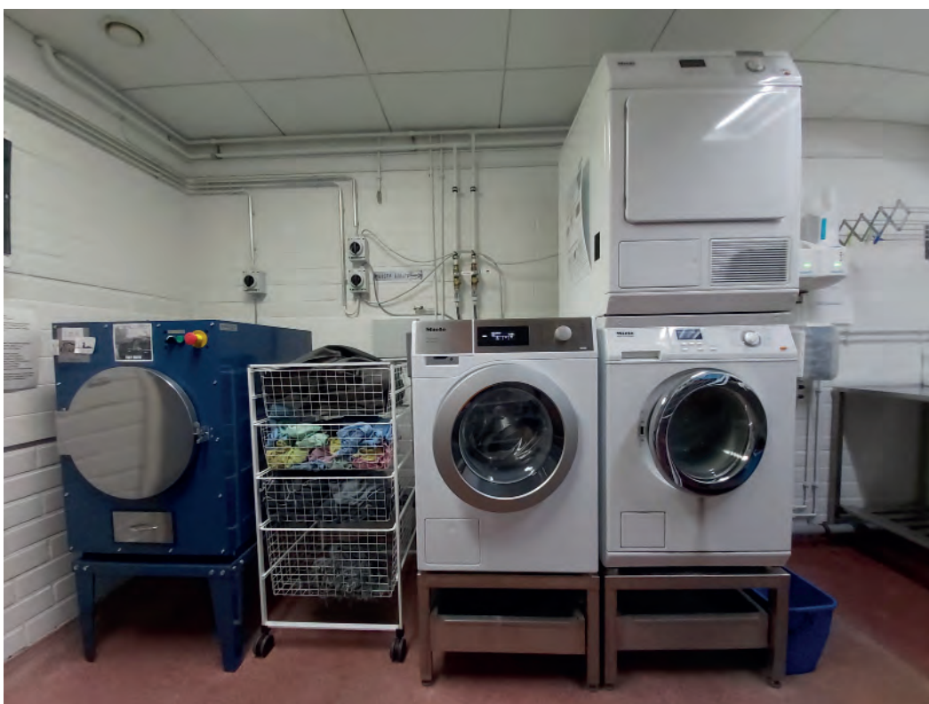
Tekstiilienhuoltokoneet kiinteistöissä, moppien esipuhdistus, pesukone, kuivausrumpu (Kuva:Erja Mickelsson)
